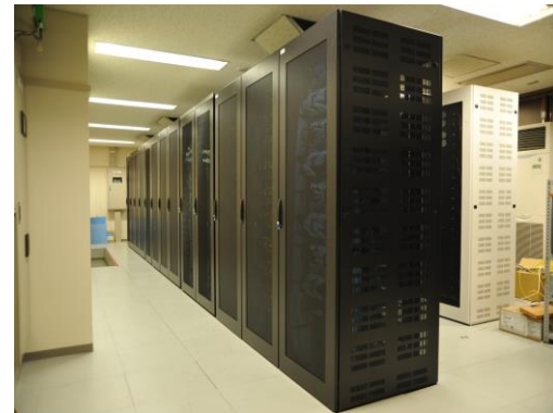
サーバ室内の様子
